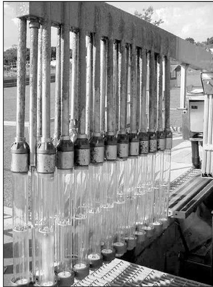
Figura 6.15 Detalhe de um arranjo de lâmpadas UV protegidas por envoltório de quartzo.
